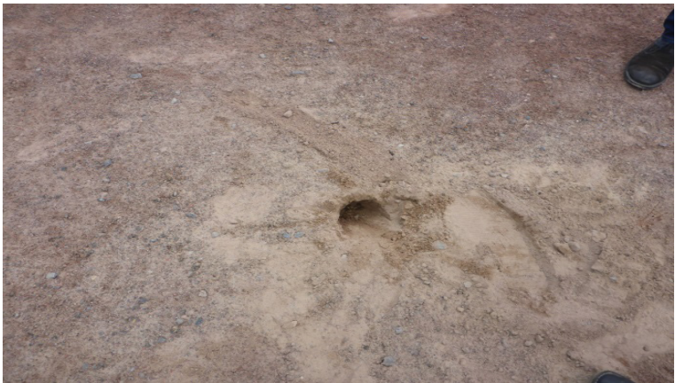
Löcher im Tennenbelag und Grobkorn auf der Deckschicht
