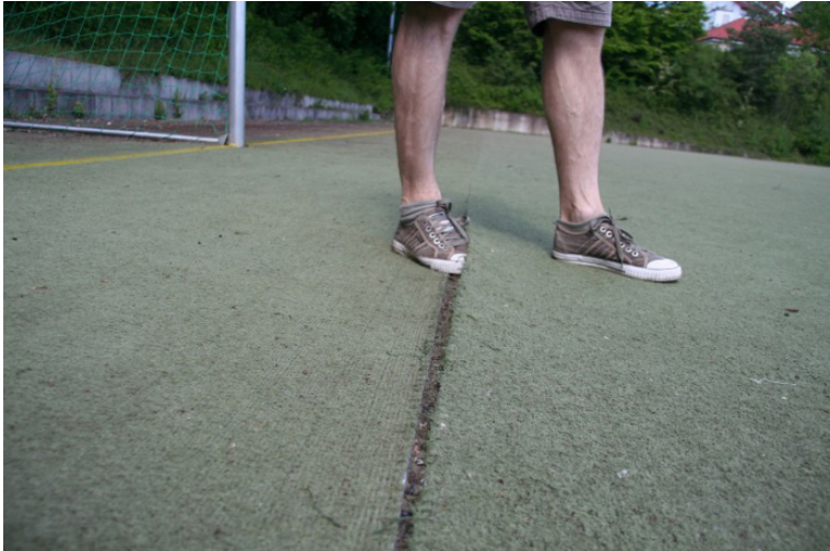
Offene Nähte im Kunststoffrasenbelag. Zudem ist der Belag deutlich abgespielt.
