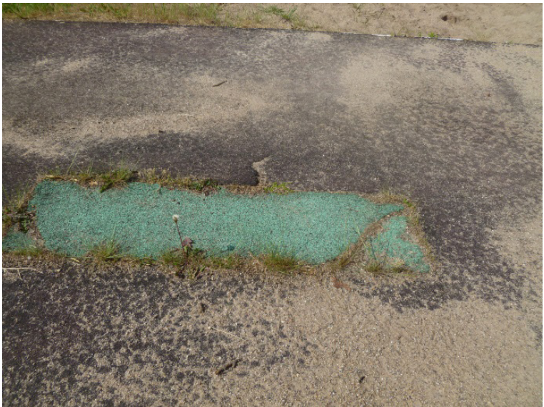
Defekter Belag und Absprungbalken an der Sprunggrube können zu Stolpern und Stürzen von Nutzern führen.
