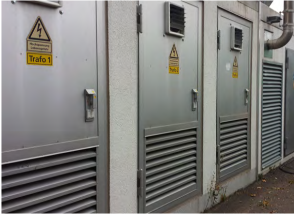
Außen-Container Trafo, Kaiserslautern
