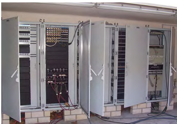
Übergabeschränke am TV Compound (Stadion Mönchengladbach)
