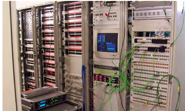
Abb. 6: Beispiel der Übergabeanschlüsse für Ü-Wagen des Datentransfers (Köln-Arena)
