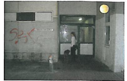
Die Hauseingänge machten einen verfallenen, wenig einladenden Eindruck.
