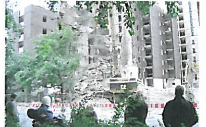
Die Abrisse werden aufmerksam von den z.T. ehemaligen Bewohnern beobachtet, teilweise auch mit großem Wehmut. Schließlich hatten sie in diesen Häusern lange gelebt.
